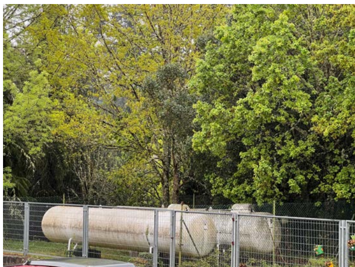
Depósito de Gas
