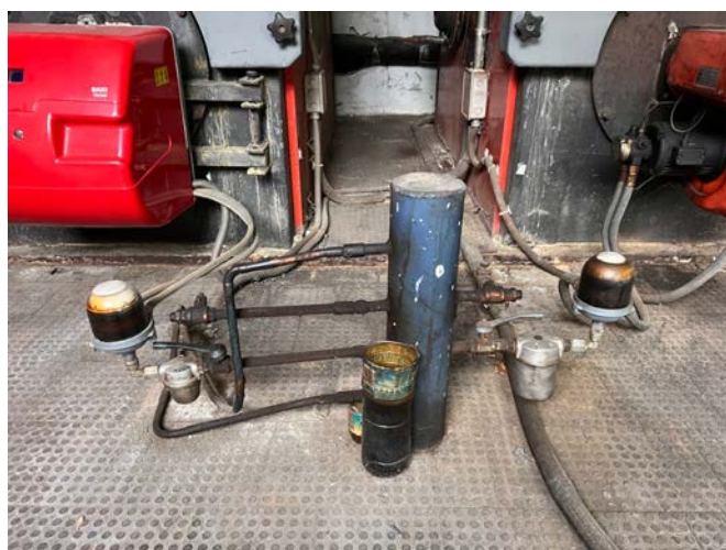
SALA DE CALDERAS SUMINISTRADA POR GAS-OI
