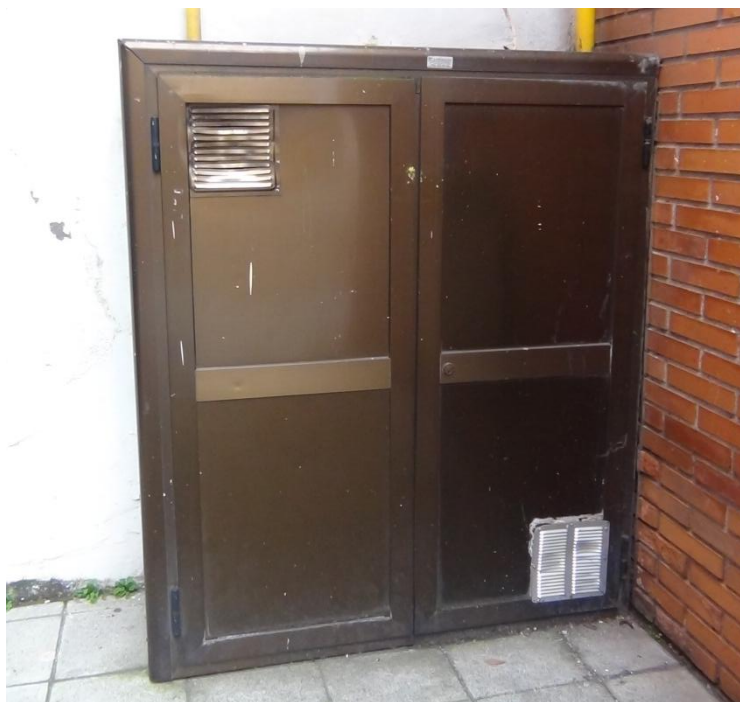
Factor de riesgo asociado a la instalación de gas. Instalación de gas
