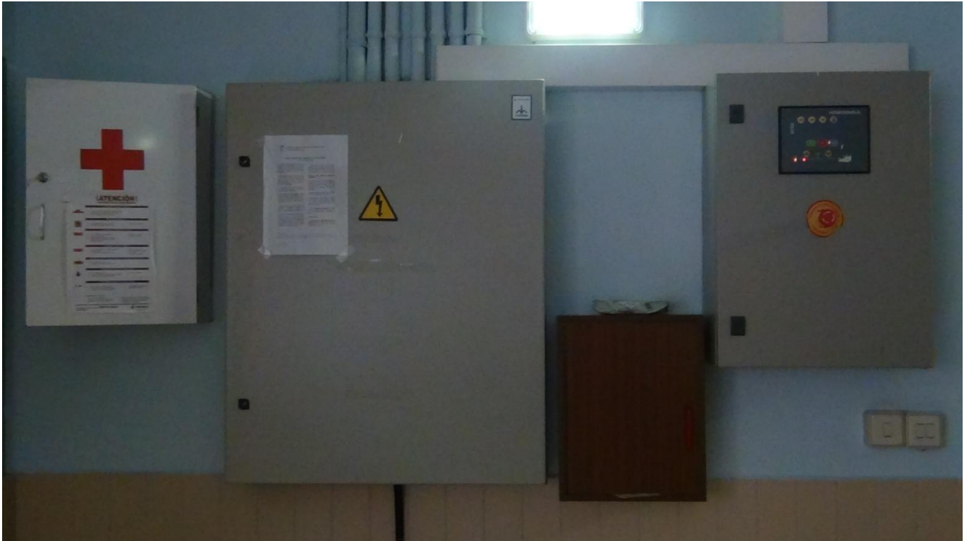
Factor de riesgo eléctrico. Cuadro eléctrico general
