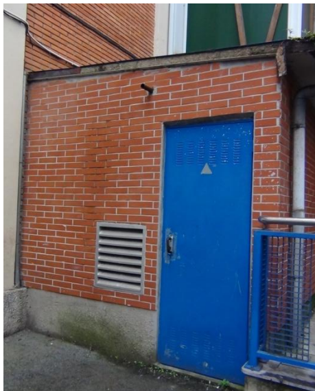
Factor de riesgo eléctrico. Generador (SIN FUNCIONAMIENTO)
