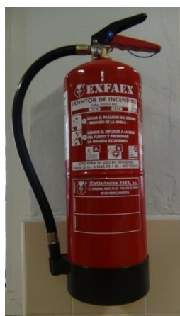
Extintor del centro
