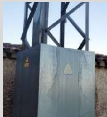
Torre de Alta Tensión
