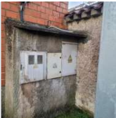
Cuadros eléctricos pared Edificio Conserje
